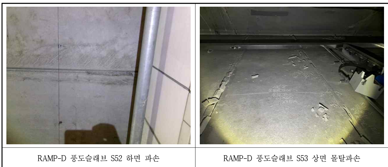
【사진 3.3.28】 NATM구간 풍도슬래브 손상현황
