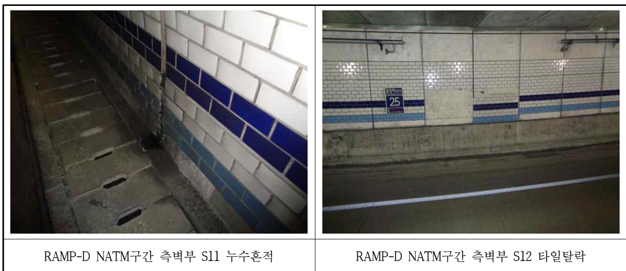
【사진 3.3.26】 NATM구간 측벽부 손상현황
