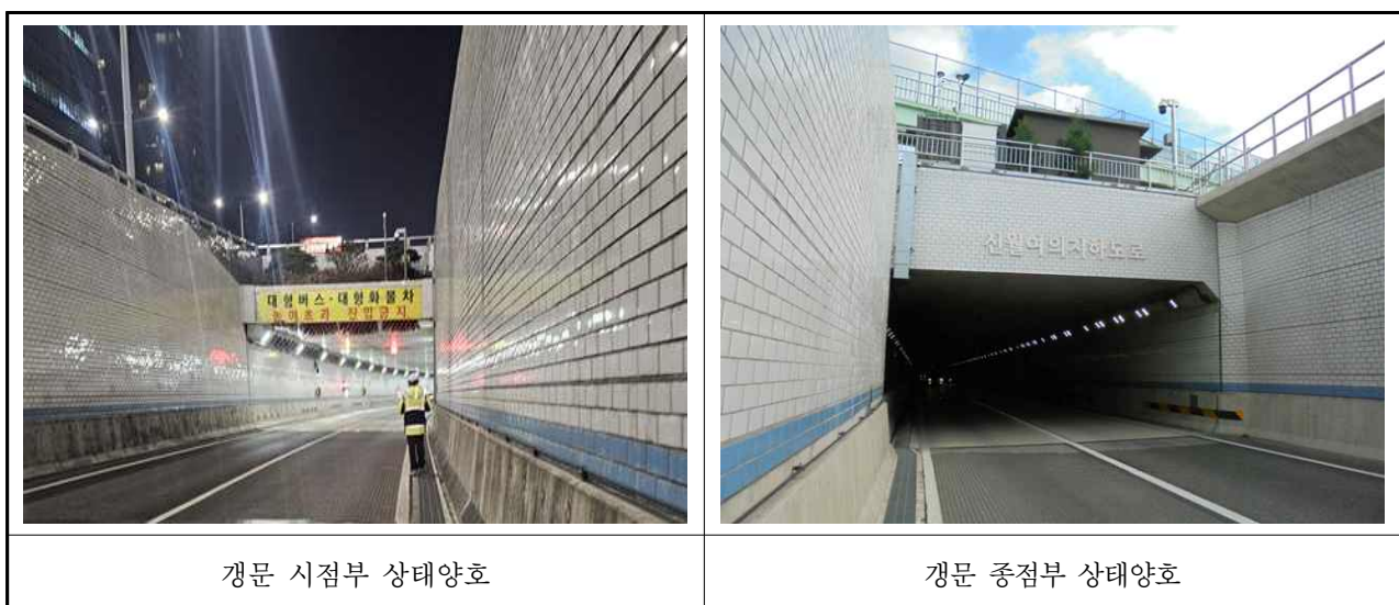
【사진 3.3.18】갯문 손상현황
