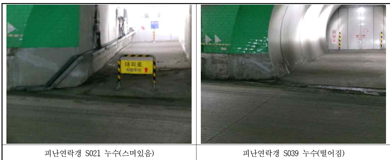
【사진 3.3.38】 피난연락갱 손상현황
