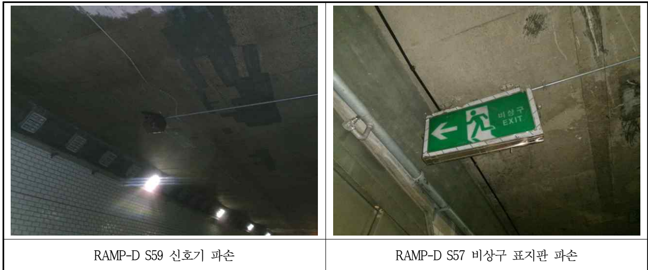
【사진 3.3.44】기타시설 손상현황
