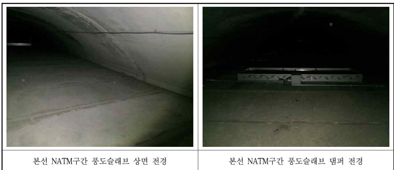
【사진 3.3.10】 NATM구간 풍도슬래브 손상현황
